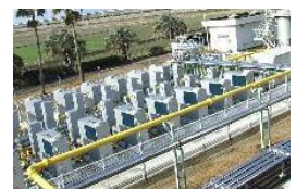
消化ガス発電設備
