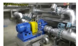
小水力発電設備
